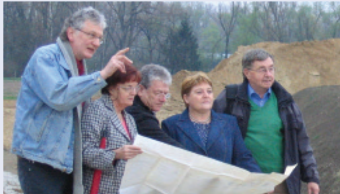
SPD-Ortsbeiratsmitglieder (v.l.n.r.: Gerhard Strotkötter, Helga Kasten, Paul Stenner und Cläre Holzkämper) besichtigen mit dem SPD-Umweltexperten Prof. Gerfried Gebert die Bauarbeiten am Polder.
